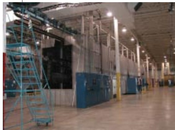
Cámara de deshumidificación
